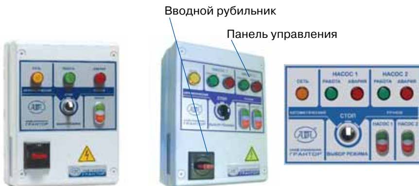
Рис. 1. Вид передней панели шкафа на один электродвигатель
